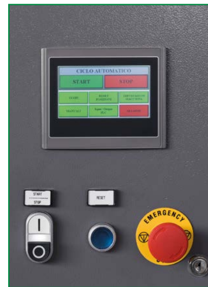
🇮🇹 Pannello operatore Touch Screen con PLC
